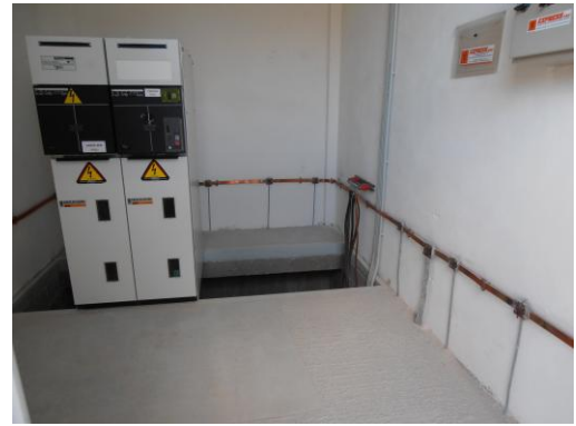
Εσωτερικό κτίσματος Υποσταθμού
